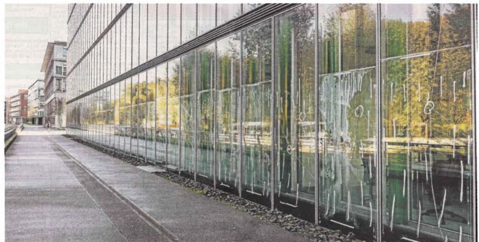
Die gesamte Fensterfront des Unternehmens Free Now in Neumühlen wurde beschädigt.
