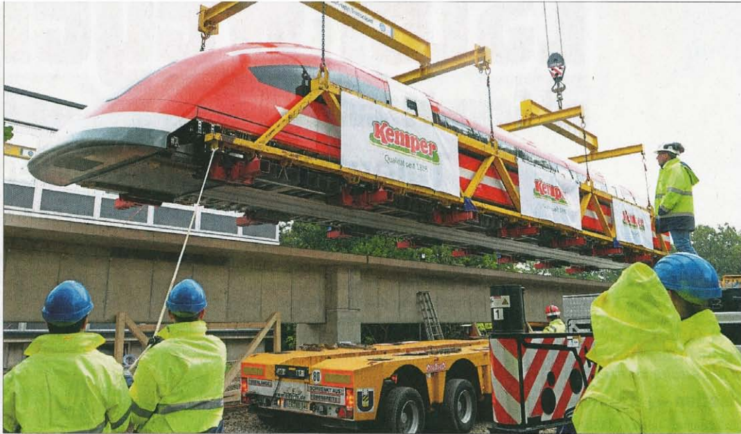
Geschafft: Am Nachmittag hängt der erste Teil des rot-weißen Magnetzuges schließlich am Haken und wird an seine endgültige Position vor der Zentrale der Firma Kemper an der Hauptstraße in Nortrup gehievt. Zwei Autokräne sind im Einsatz. Bei den Helfern muss jeder Handgriff sitzen.
