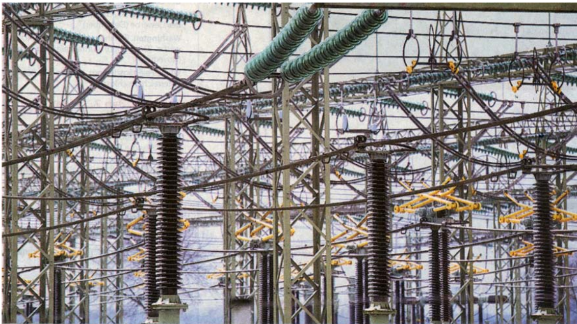
Komplexes System: Umspannwerk im rheinischen Osterath
