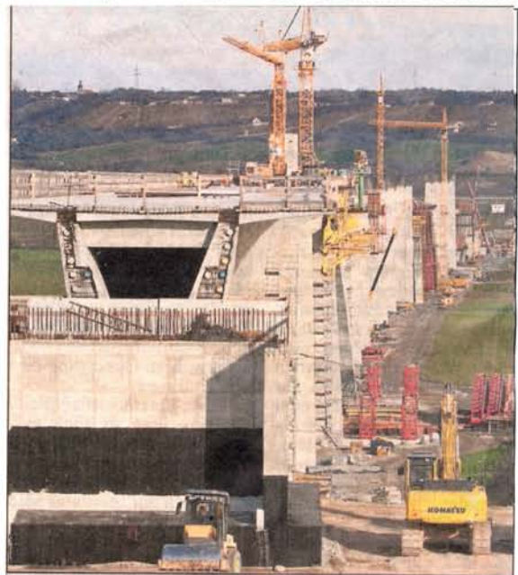
Am Osterbergtunnel im Hintergrund gelang gestern der Durchbruch auf dem Teilstück der neuen ICE-Strecke Erfurt-Leipzig.
